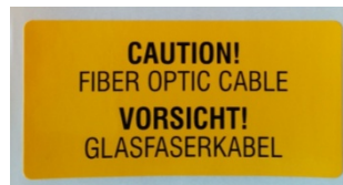
Abbildung 19: Aufkleber „Vorsicht Glasfaserkabel“
